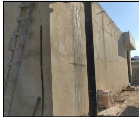
Reservatório elevado do Sistema de abastecimento de água do Distrito de Alter do Chão, no Município de Santarém – Pa.
