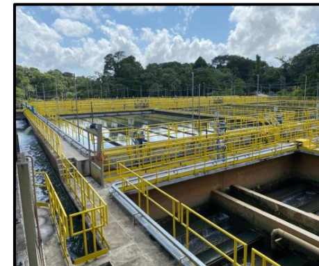
Vista Geral dos Decantadores da Estação de Tratamento de Água da ETA Bolonha
