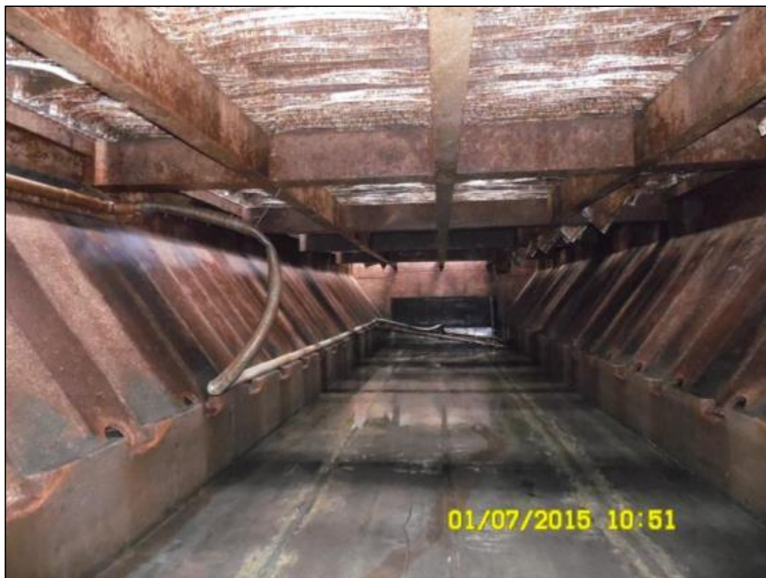
Figura 4.4 – Vista geral dos decantadores implantados em segunda etapa na ETA Bolonha - Decantadores de alta taxa
