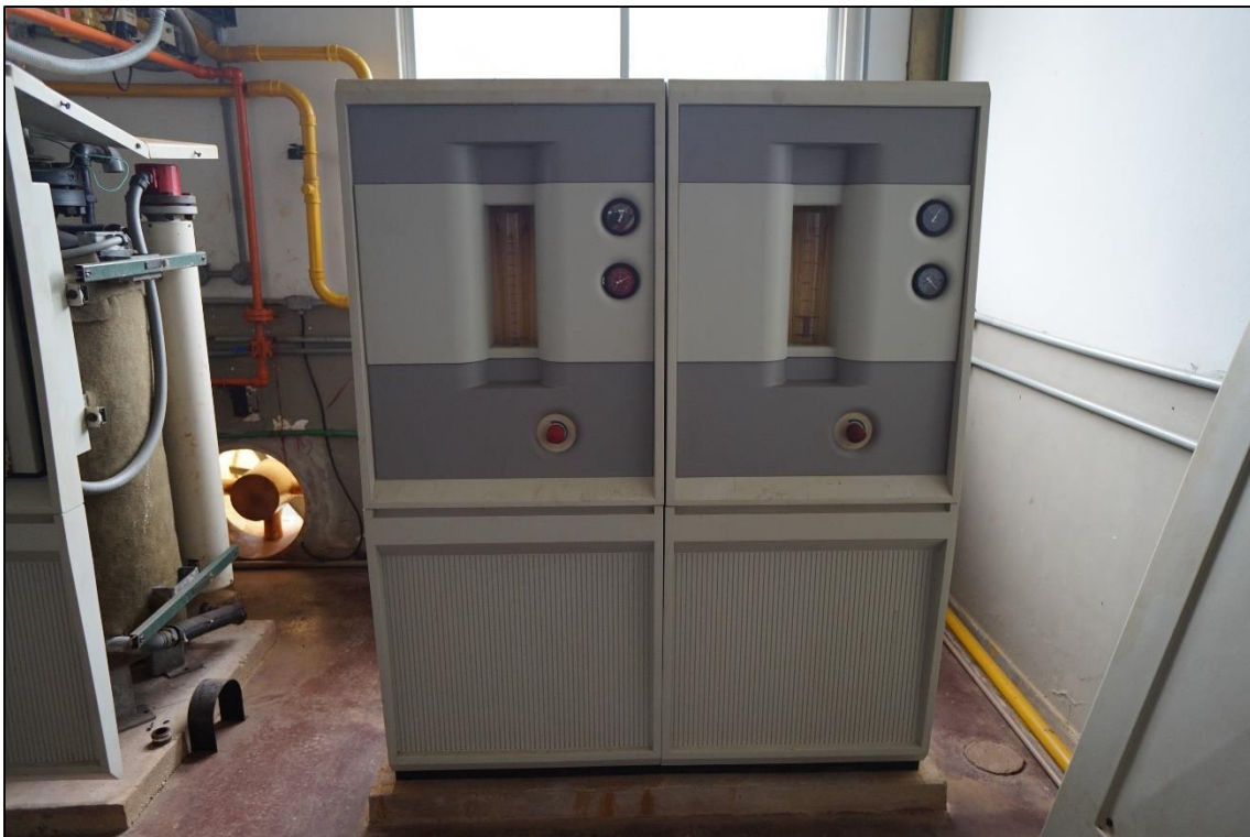
Figura 6.9 – Vista geral dos cloradores em operação na ETA Bolonha
