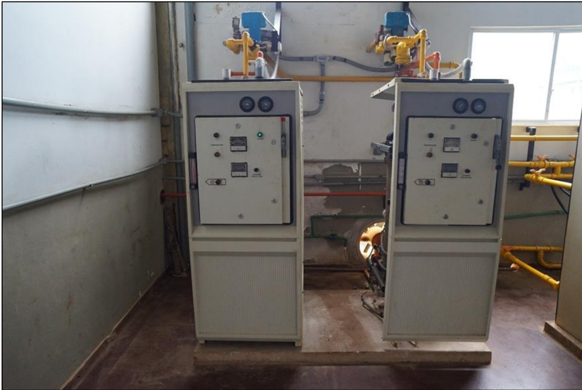
Figura 6.8 – Vista geral dos evaporadores de cloro em operação na ETA Bolonha
