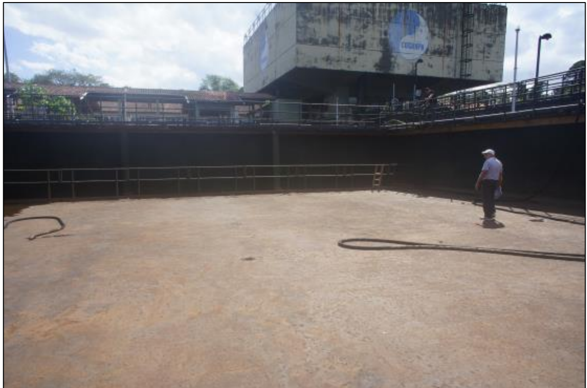
Figura 4.2 – Vista geral dos decantadores implantados em primeira etapa na ETA Bolonha - Decantadores convencionais de fluxo horizontal
