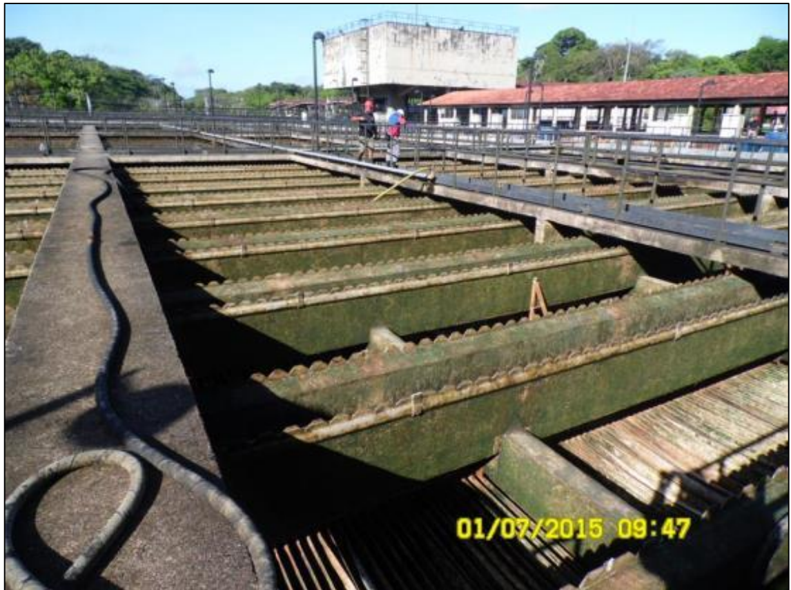
Figura 4.3 – Vista geral dos decantadores implantados em segunda etapa na ETA Bolonha - Decantadores de alta taxa
