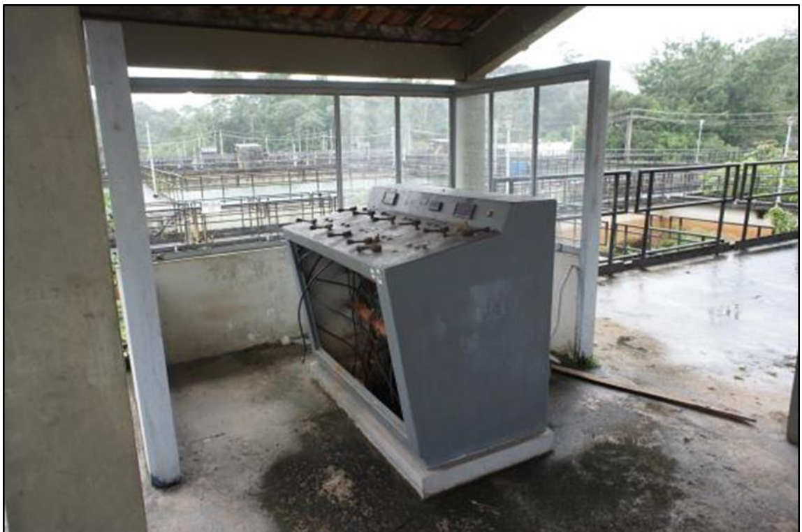
Figura 2.12 – Vista geral da Tabela de comando das válvulas de um dos filtros implantados na primeira etapa na ETA Bolonha – Mau estado de conservação de equipamentos e demais itens acessórios
