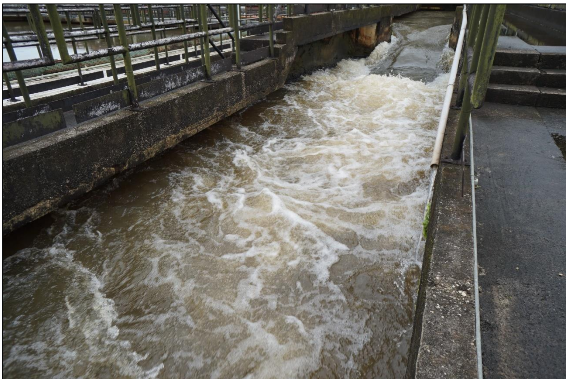
Figura 6.5 – Ponto de aplicação de polímero como auxiliar de floculação imediatamente a jusante da Calha Parshall
