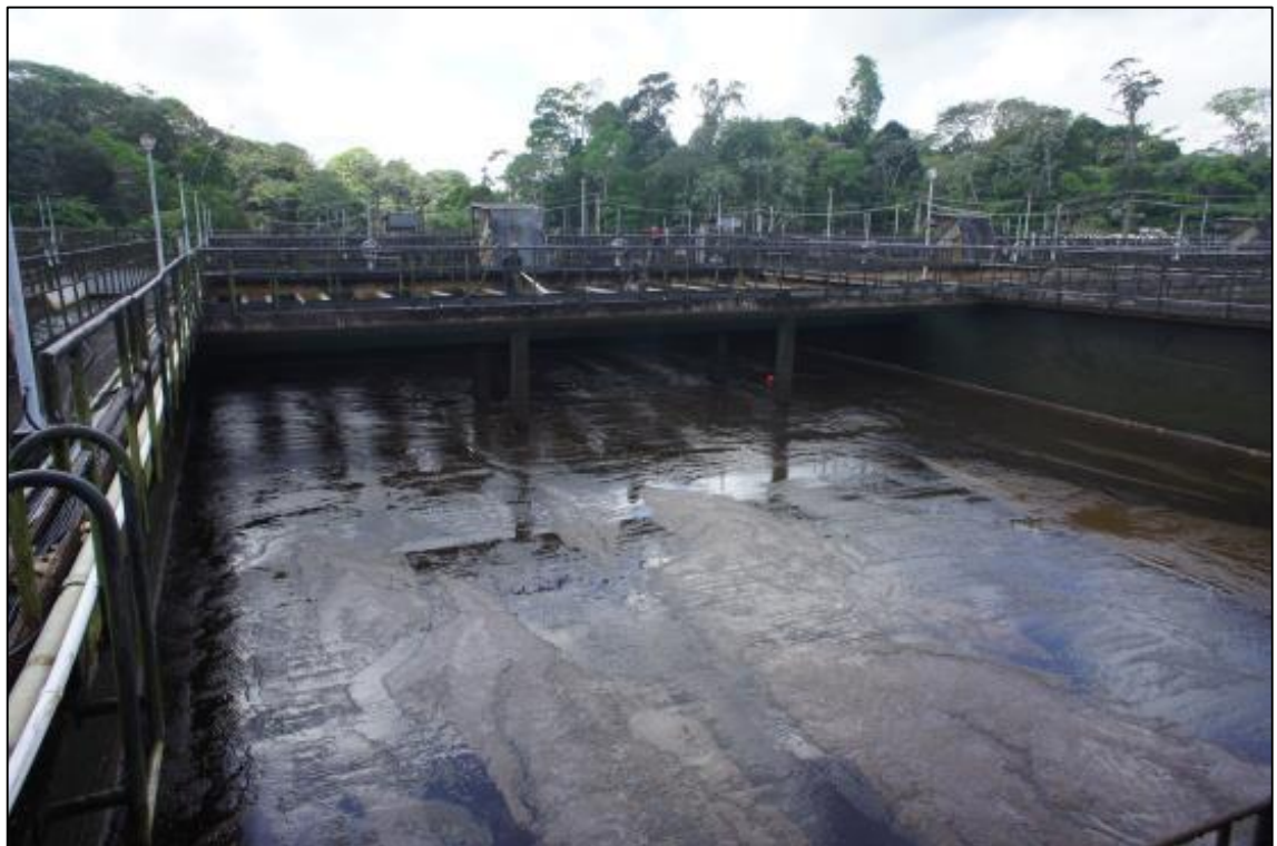
Figura 4.1 – Vista geral dos decantadores implantados em primeira etapa na ETA Bolonha - Decantadores convencionais de fluxo horizontal
