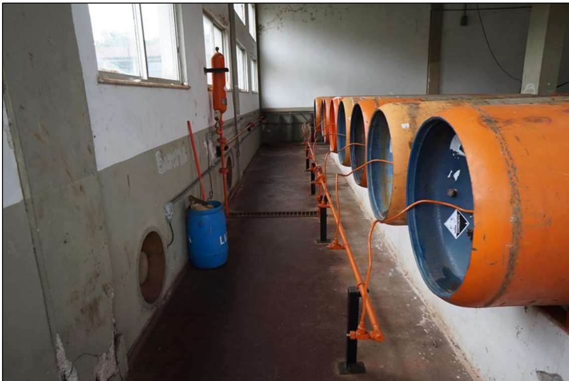
Figura 6.7 – Vista geral da sala de cilindros de cloro em operação na ETA Bolonha
