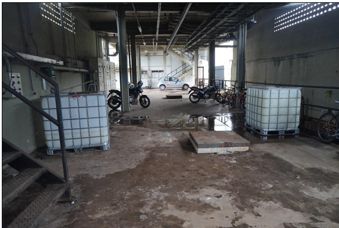
Figura 6.6 – Tanques de polímero em emulsão em operação na ETA Bolonha
