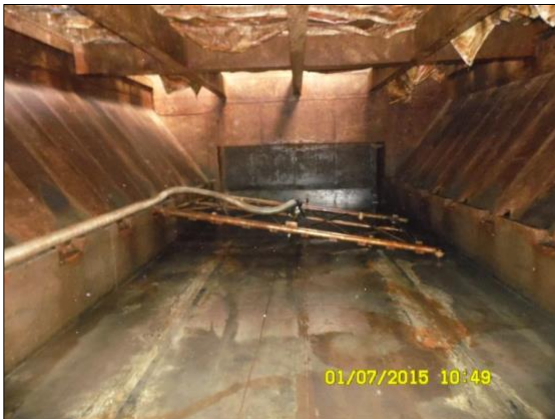
Figura 2.9 – Equipamentos de remoção de lodo instalados nos decantadores implantados em segunda etapa na ETA Bolonha - Decantadores de alta taxa
