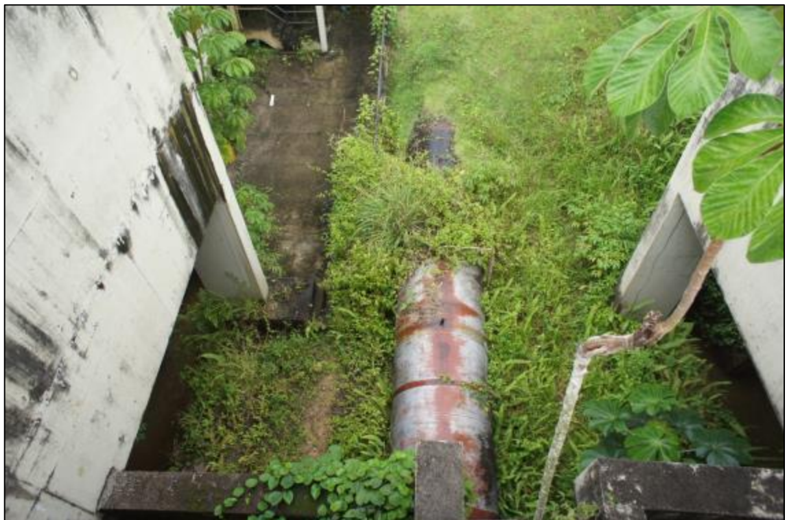
Figura 2.3 – Vista geral do ponto de aplicação de coagulante diretamente na adutora de chegada de água bruta – ETA Bolonha
