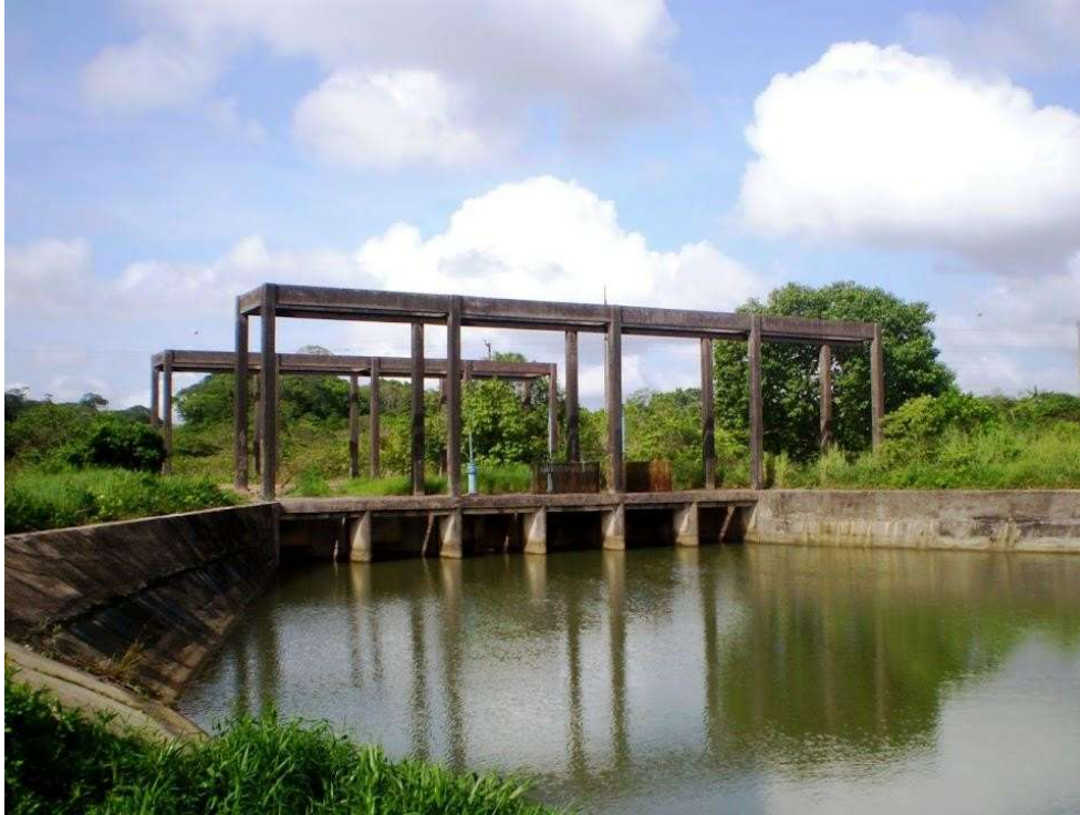
Figura 106: Sistema de Comporta no Açude Água Preta
