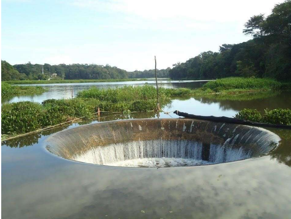
Figura 104: Sangrador de Água Açude Bolonha – Sistema Tulipa
