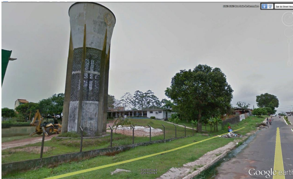
Figura 8: Imagem do Setor Souza Franco - Área 1 – Reservatório Elevado Inoperante
