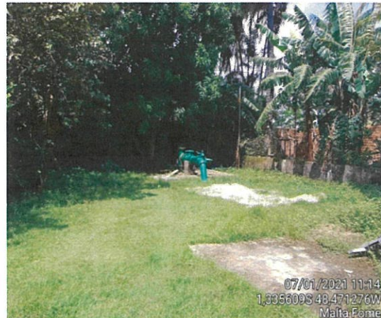
Figura 27: Poço existente e em funcionamento
