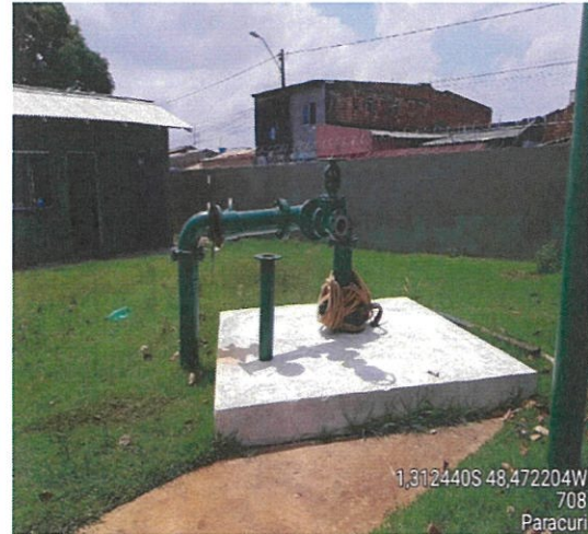
Figura 25: Poço existente e em funcionamento
